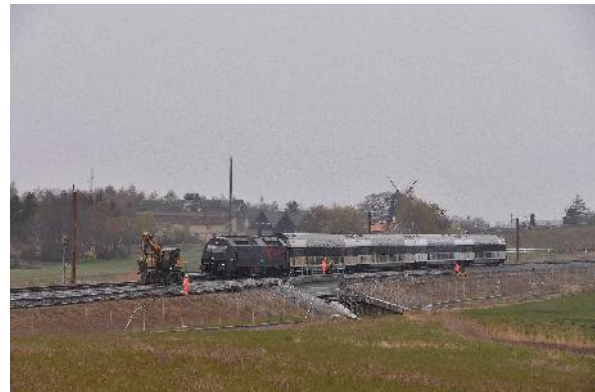
DSB ME 1519 afgår med tog 2249 fra Ek kl. 14.48½. Ek Mølle ses i baggrunden. Man er i gang med at trække skinner på plads til det nye spor.
