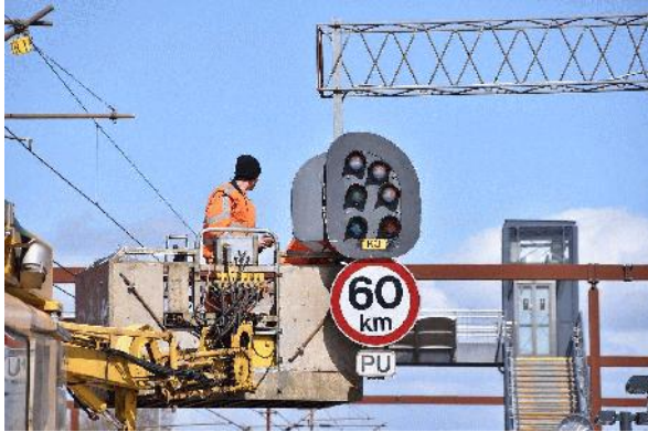
To gange årligt rengør ENT signalerne; den ene gang også indvendigt og pærerne skiftes. Foto i Te .
